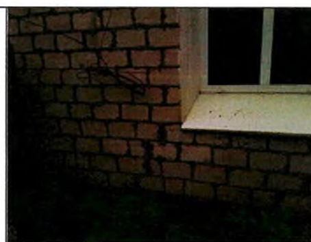
Трещины кирпичной кладки на фасаде
