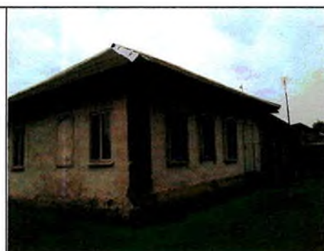
Требуются ремонтные работы фасада, фундамента
